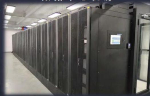
数据中心机房
